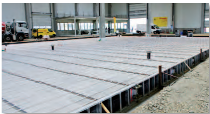
Betonplatte mit Rohrregistern als Zwischenspeicher
