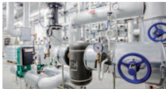
Energiezentrale der Nahwärme Pleið
