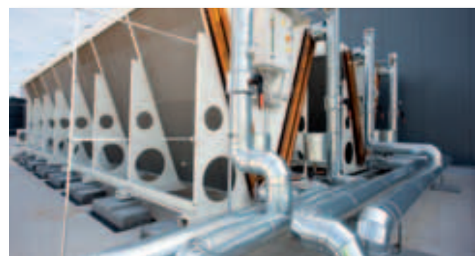
Kiesel Mitte GmbH, Stockstadt/Rh. (Bildquelle Viessmann)
