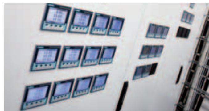
Niederspannungshauptverteilung mit Universal-Messgeräten
