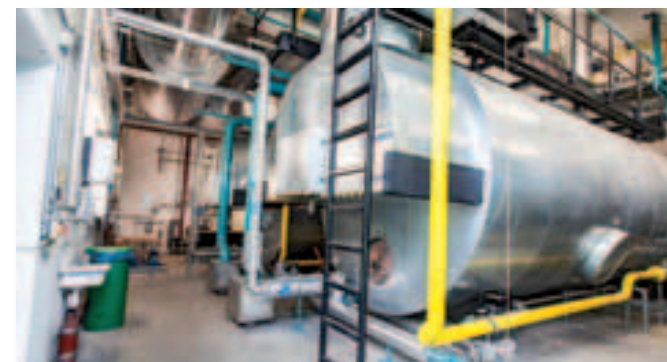
ZAK Abfallwirtschaft GmbH, Kempten (Energiezentrale Heißwasser)
