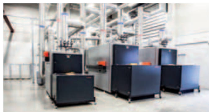
Grob Werke GmbH & Co.KG, Mindelheim (Energiezentrale)
