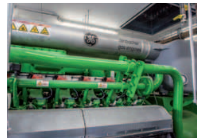
Dachser SE Logistikzentrum Allgäu, Memmingen – KWKK Anlage
