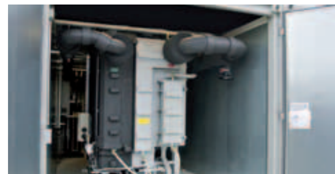
Alois Berger GmbH & Co. KG, Memmingen – Absorptionskältemaschine
