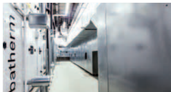
Klinikverbund Kempten-Oberallgäu gGmbH, Klinikum Kempten
